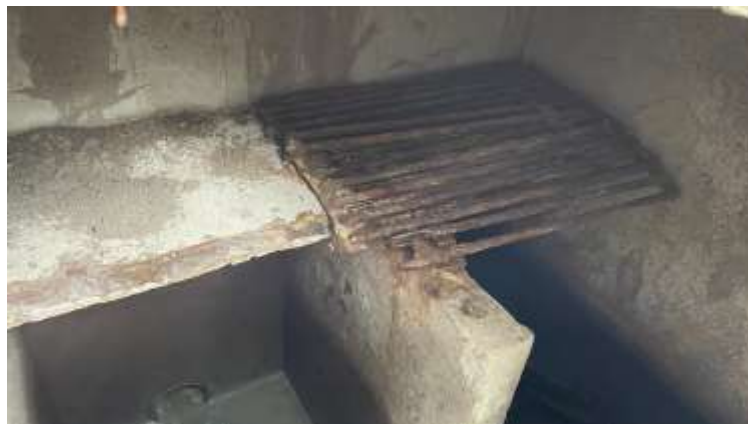
Ilustración 22. Rejillas de la PTAR El Rosal.
