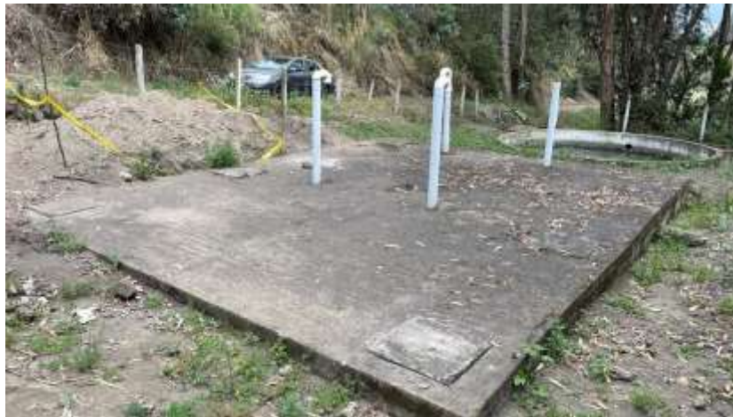
Ilustración 23. Pozo séptico de la PTAR El Rosal.
