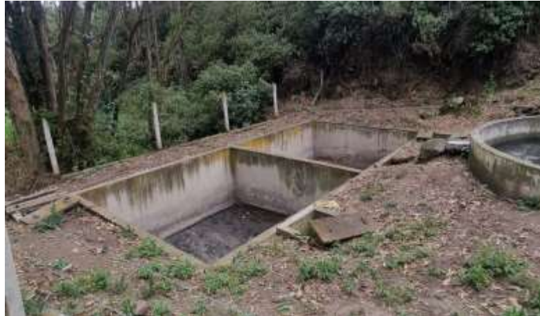
Ilustración 24. Tanque de lecho de lodos PTAR El Rosal.
