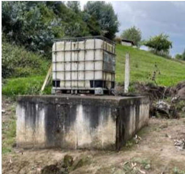
Ilustración 21. Tanque de criba de la PTAR el Rosal
