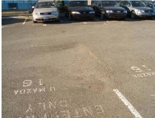
Figura 12. Abultamiento y hundimiento
