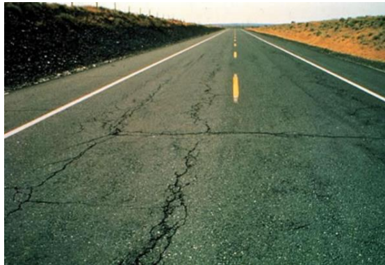
Figura 11. Agrietamiento en bloque
