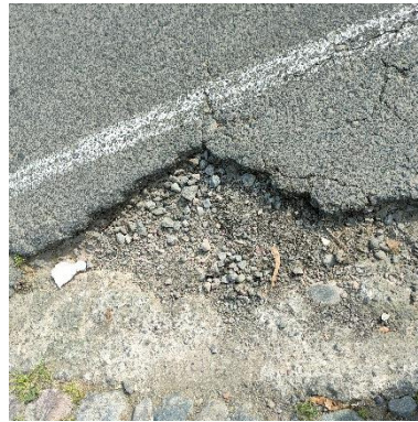
Figura 15. Grieta de borde
