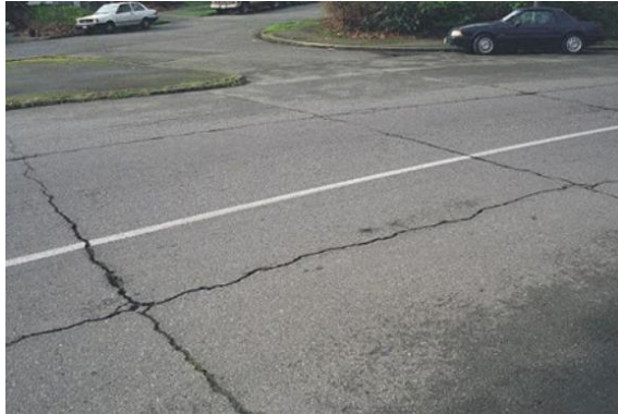
Figura 16. Grieta de reflexión de junta
