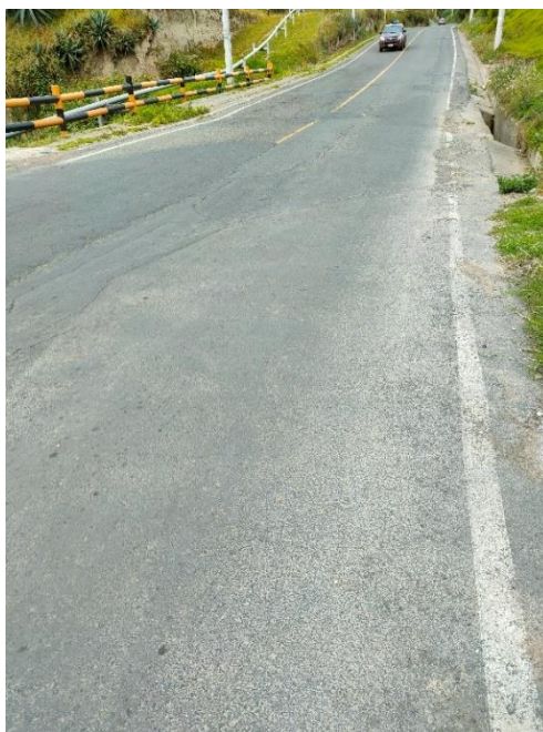
Figura 48. Área afectada por anomalías tramo 4+040 hasta 4+070
