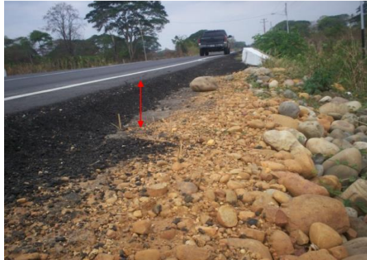
Figura 17. Desnivel carril / berma
