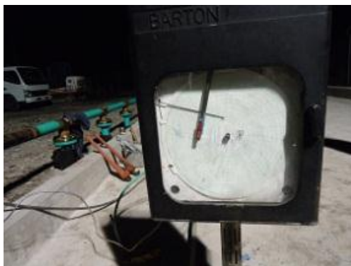
Foto 6.35. Registrador de Presión y Temperatura “Barton”.
