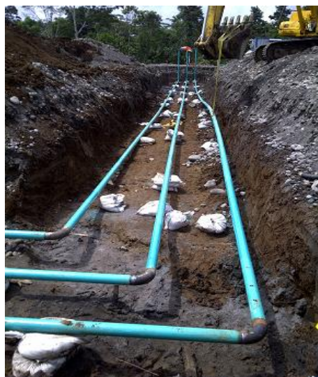
Foto 6.31. Colocación de líneas sobre sacos de arena.
