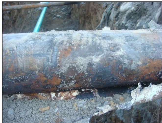
Foto 1.1. Tubería de conducción de crudo corroída NPS 4”, SCH 80
