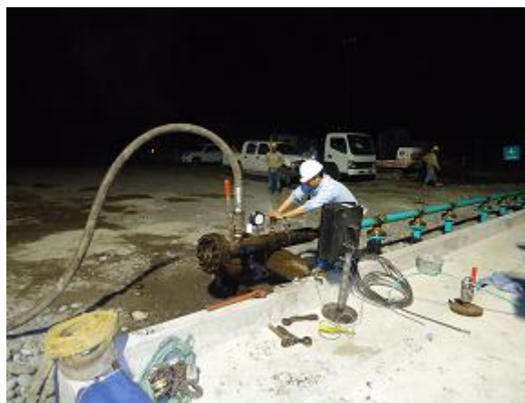
Foto 6.38. Drenaje de líneas desde válvula de cabezal.
