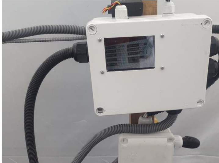
Figura 40: Protección para HMI, módulo de comunicación, microcontrolador y placa electrónica
