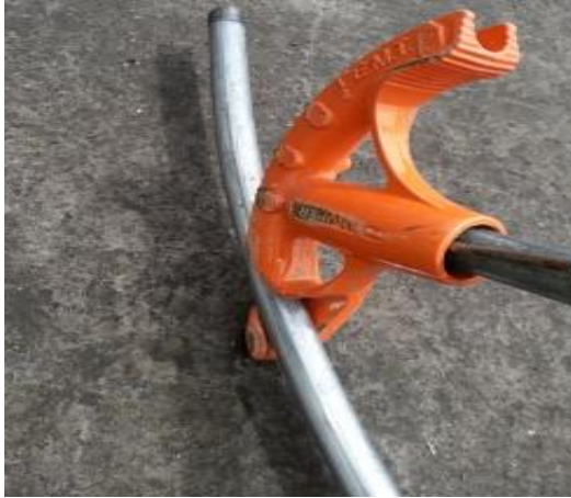
Figura D1: Doblado de tubos galvanizado para soporte de cubierta. Elaborado por: el investigador
