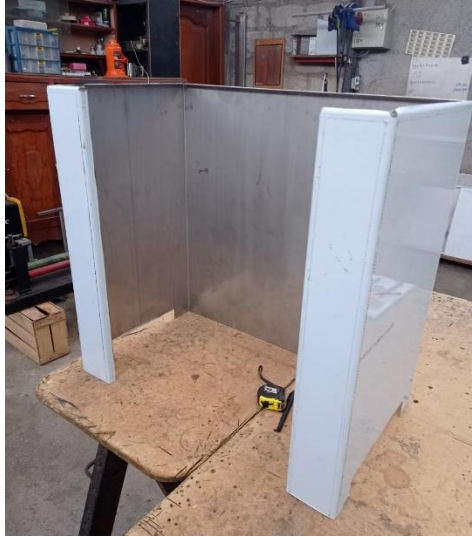
Figura 27 Partes de la cámara de combustión dobladas
