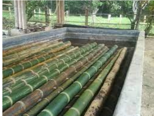
Ilustración 7. Piscinas de preservación
