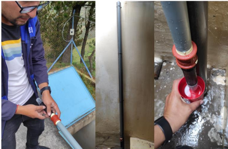
Figura 37. Instalación del sensor de PH y de temperatura
