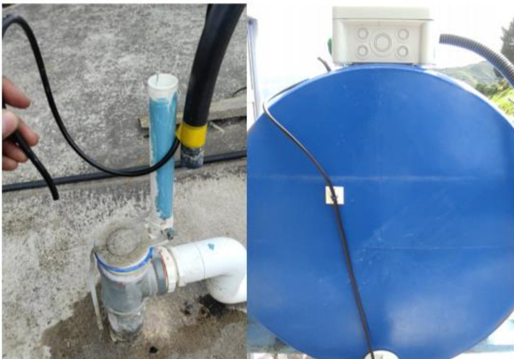
Figura 46. Sistema de control del hlorito de sodio
