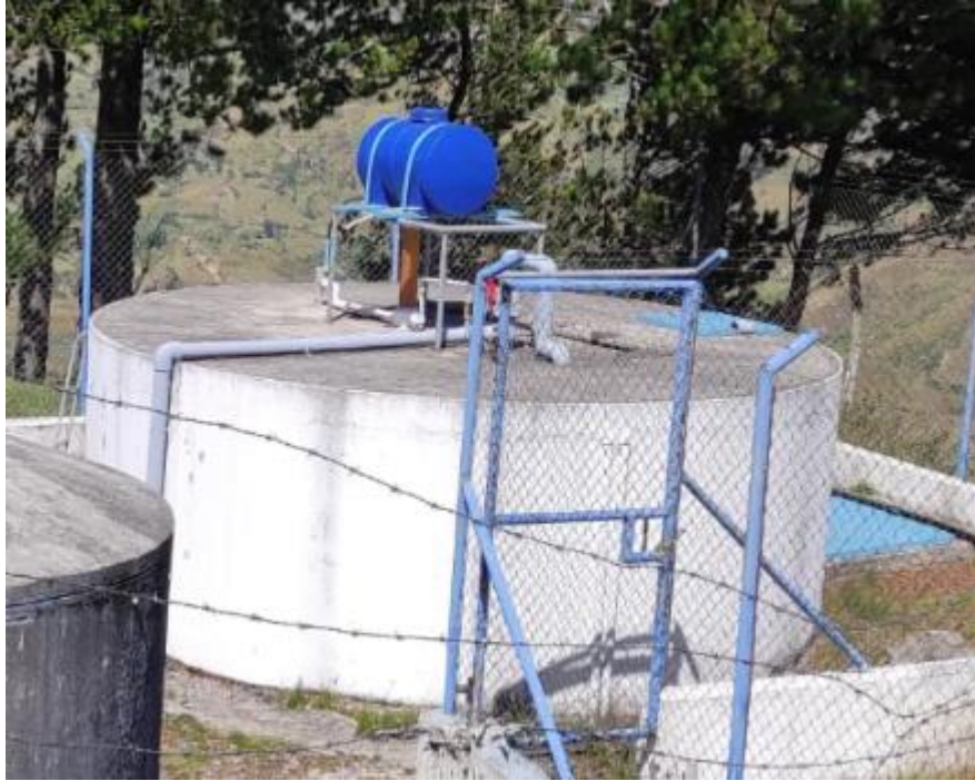
Figura 33. Tanque principal de agua y de cloro
