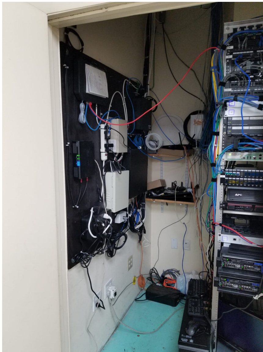
Figura 3.6: Entrada al cuarto de servidores Elaborado por: Paúl Montesdeoca
