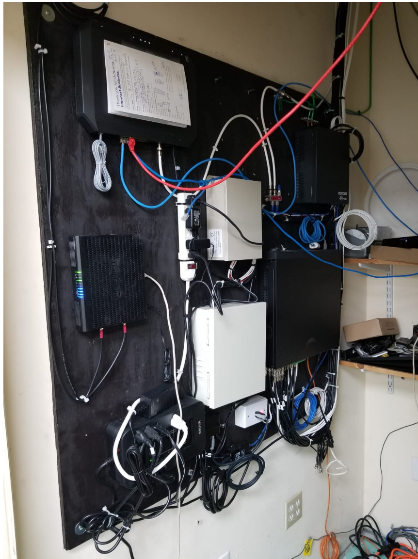
Figura 3.7: Panel de control del cuarto de servidores Elaborado por: Paúl Montesdeoca
