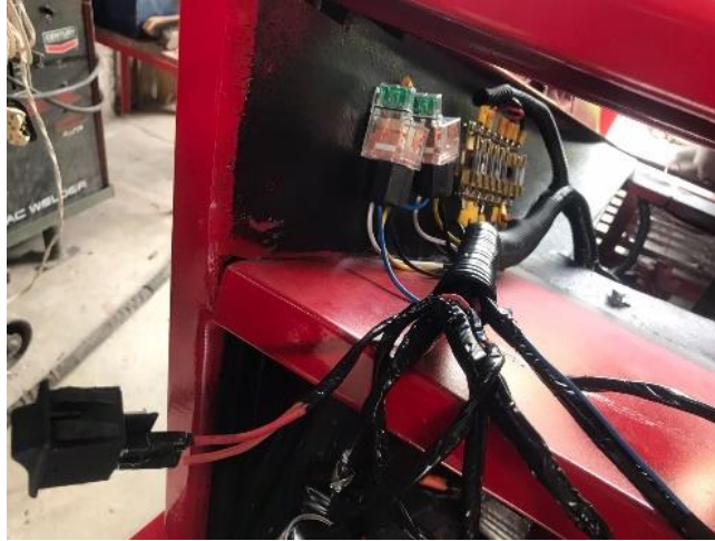
Figura 75.- Caja de fusibles para sistema eléctrico.
