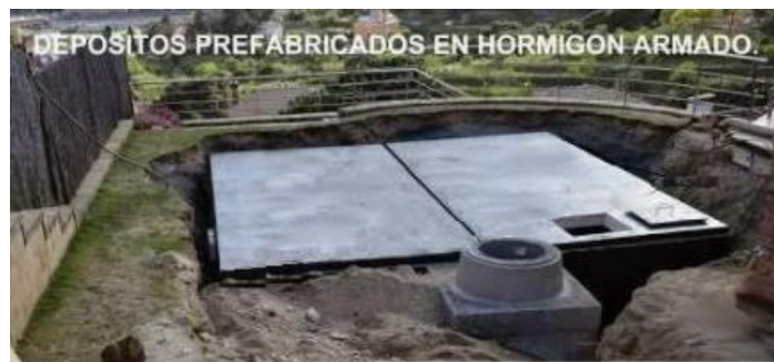
Figura 12.- Tanque de almacenamiento de agua enterrado
