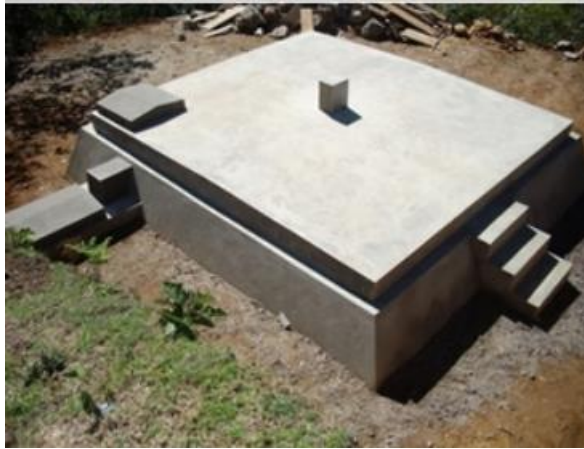
Figura 13.- Tanque de almacenamiento de agua semienterrado
