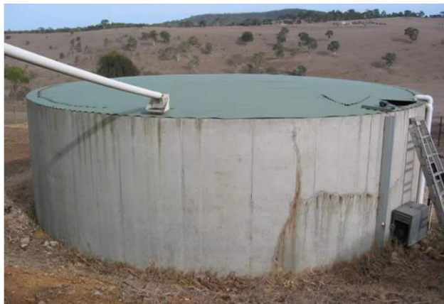
Figura 14.- Tanque de almacenamiento de agua superficial
