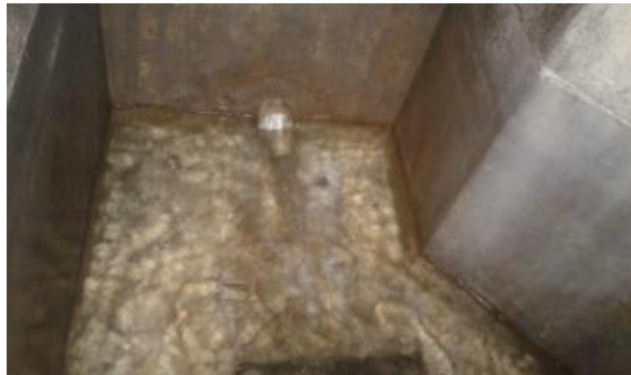
4.Captación del caudal en el tanque
