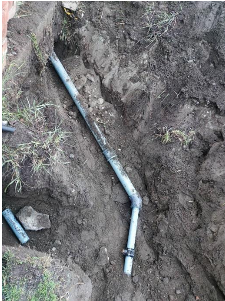
6. Red de distribución a la intemperie
