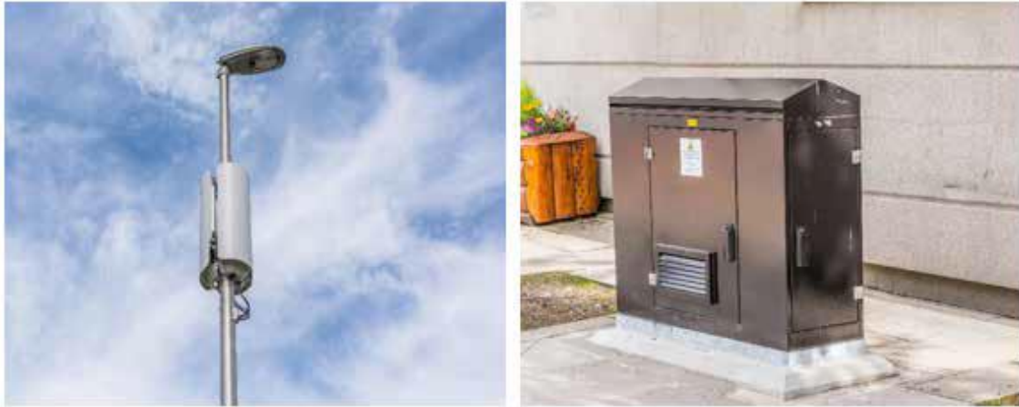
Figura. - 50 .- Sistema de antenas de células pequeñas y distribuidor [49]
