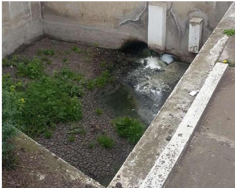
Figura 21 Lecho de secado de lodos II Fuente: Autor
