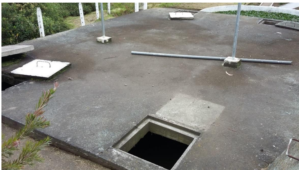
Figura 17 Tanque Séptico Fuente: Autor
