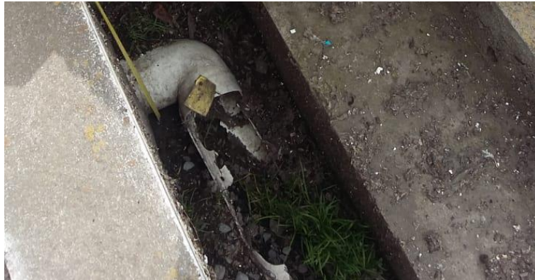
Figura 20 Tubería rota del lecho de secado de lodos I Fuente: Autor
