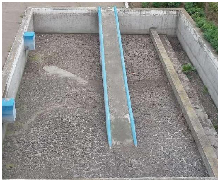
Figura 19 Lecho de secado de lodos I
