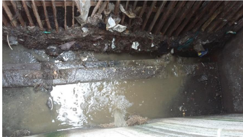
Figura 16 Tanque de Recepción Fuente: Autor
