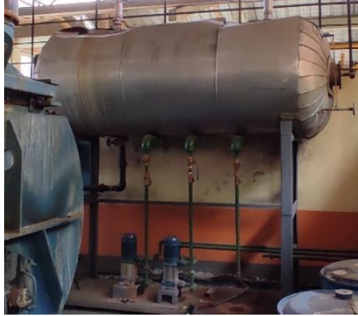
Figura 3.2: Tanque de condensado instalado.
