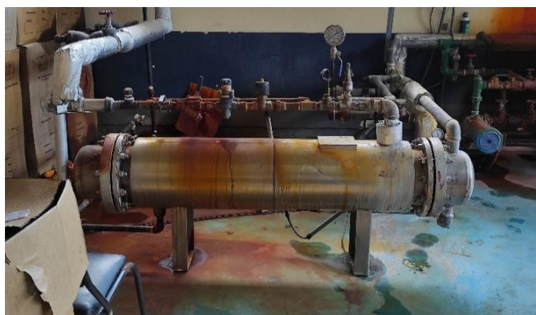
Figura 3.7: Intercambiador de calor.
