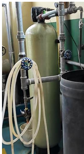
Figura 3.3: Ablandador de agua de la sala de máquinas.
