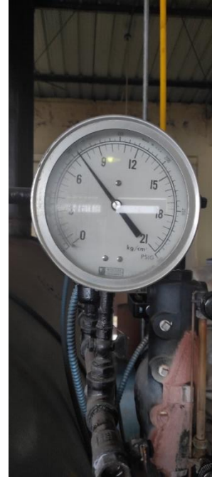
Manómetro a salida de vapor
