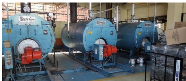
Figura 3.1: Calderos instalados en la sala de máquinas de la entidad.
