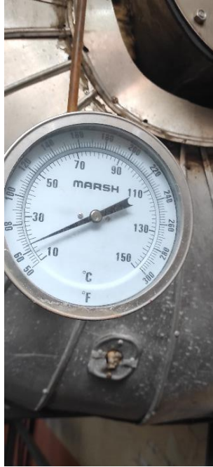
Termómetro en tanque de condensado
