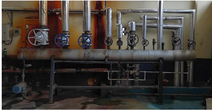
Figura 3.6: Manifold de distribución de la casa de máquinas.
