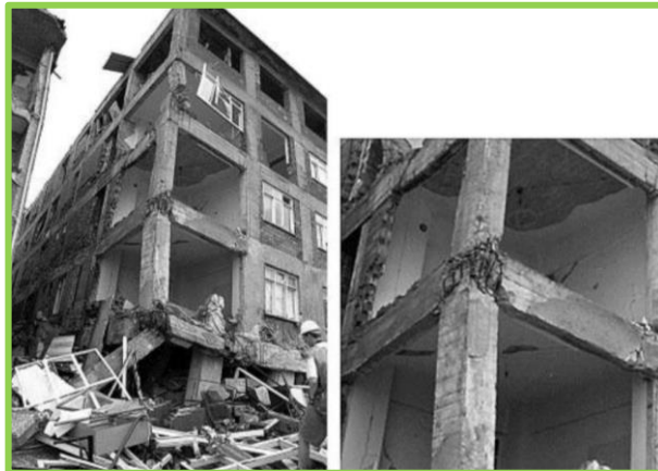
Figura 30. Fallas estructurales en las conexiones de viga–columna.
