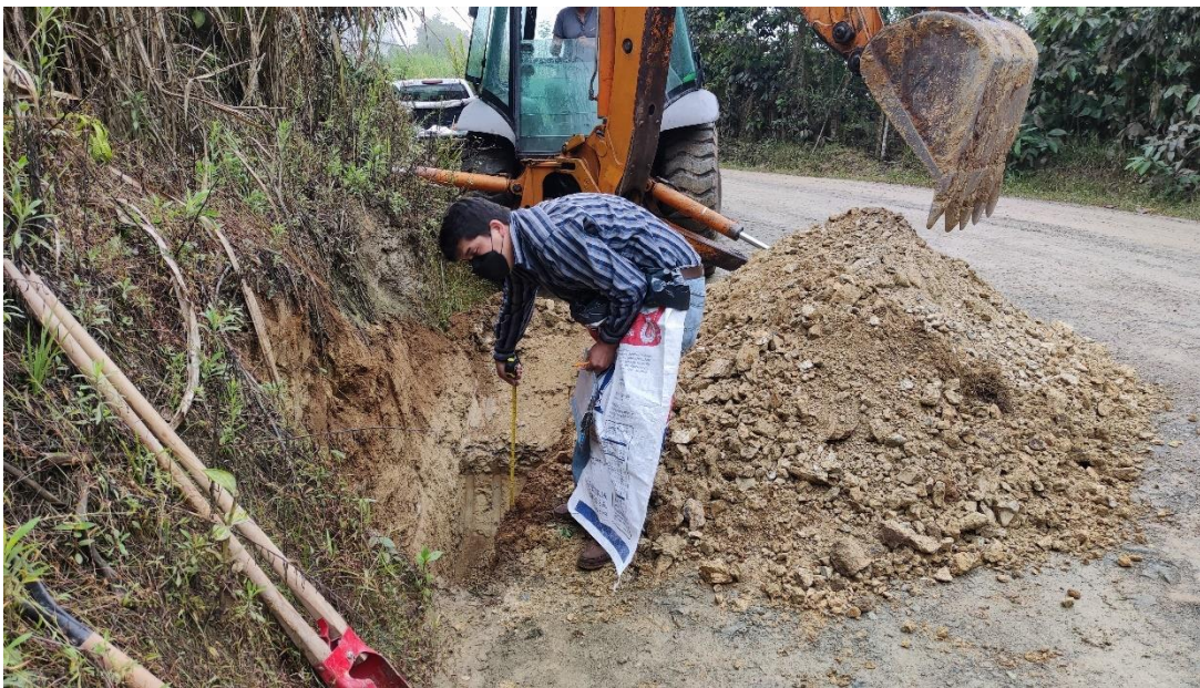
Comprobacion de nivel de -1.50m para extracion de la muestra de la Sub-Rasante de la ABS. 1+000
