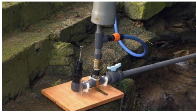
Figura 4. Bomba de ariete hidráulico instalada. [10]
