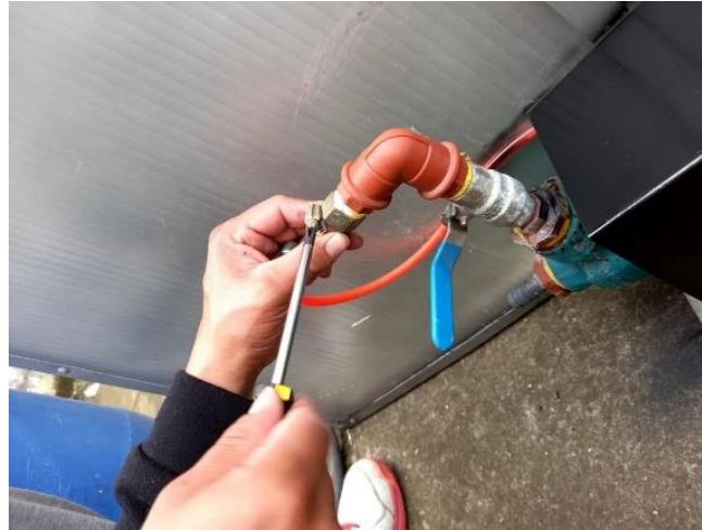
Figura 15.- Acople del tanque a la manguera a la cabina. Elaborado por: El investigador.
