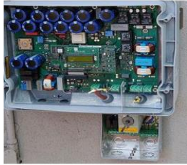
Figura 18: Parte interna de un inversor solar
