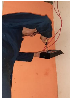
Figura 50: Conexión de las baterías al regulador solar
