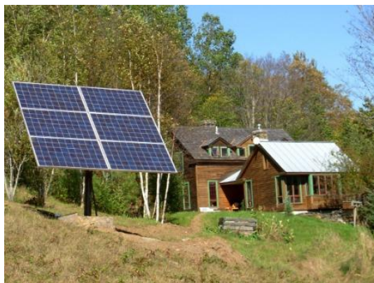
Figura 13: Instalación solar aislada
