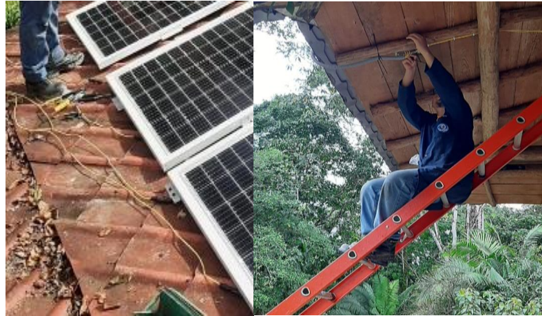
Figura 45: Conexión en paralelo de los paneles solares con repartidor de corriente
