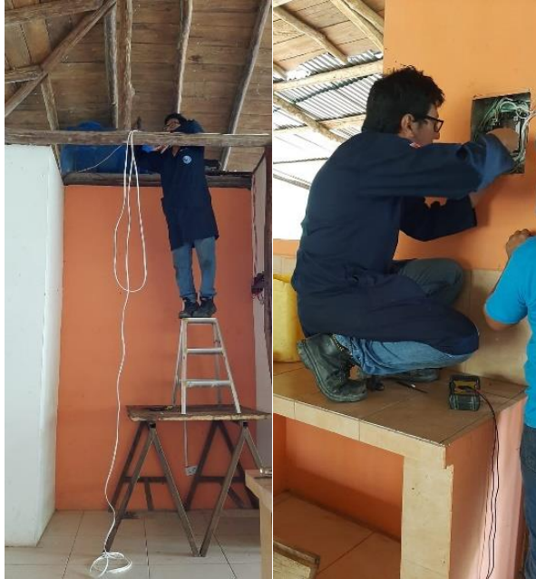
Figura 55: Conexión del inversor de voltaje hacia el tablero de conexiones de la vivienda
