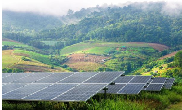
Figura 12: Paneles solares conectados en un campo para generar energía eléctrica
