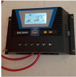
Figura 52: Regulador solar encendido y configurado
