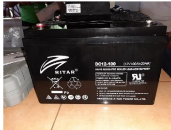
Figura 49: Batería sellada para la configuración del regulador solar
