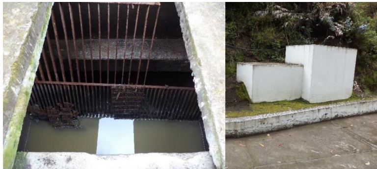
Figura 16 Desarenador de la PTAR
