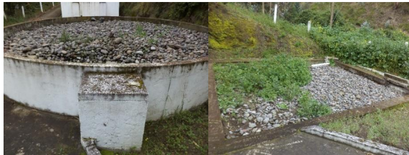
Figura 18 Filtro anaerobio de flujo ascendente y descendente de la PTAR
