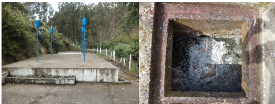
Figura 17 Tanque séptico de la PTAR
