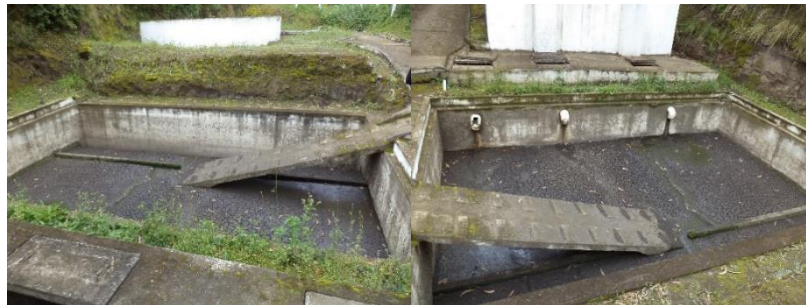
Figura 19 Lecho o patio de secado de lodos de la PTAR
