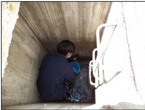
Figura 12 Toma de caudales de agua tratada de salida de la planta de Puñachizag
