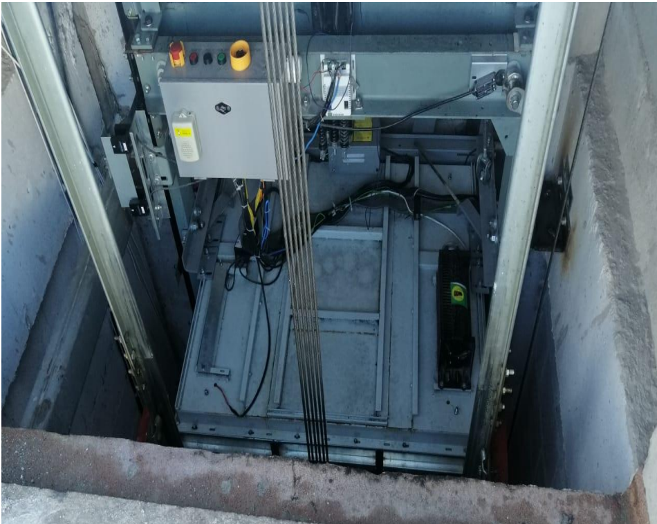
Figura 49. Instalaciones eléctricas sobre-cabina. Elaboración propia.
