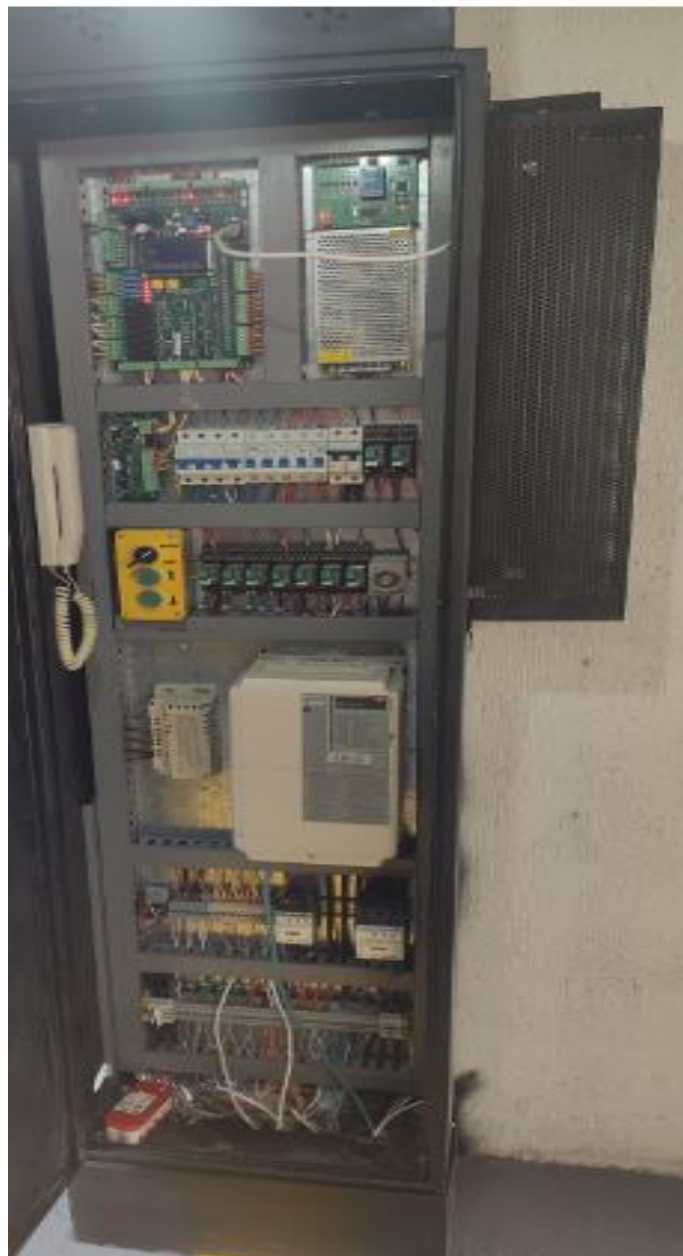
Figura 55. Ajuste de parámetros en el tablero de control de maniobra. Elaboración propia.
