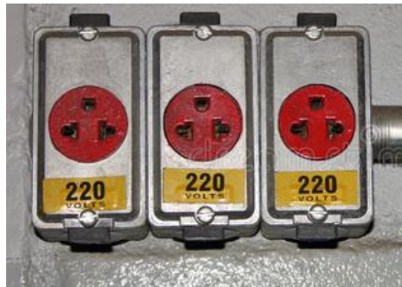
Figura 2-42. Toma de energía para el equipo TIG
