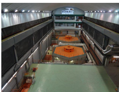
Figura 2. Casa de Máquinas Central Hidroeléctrica San Francisco [9]
