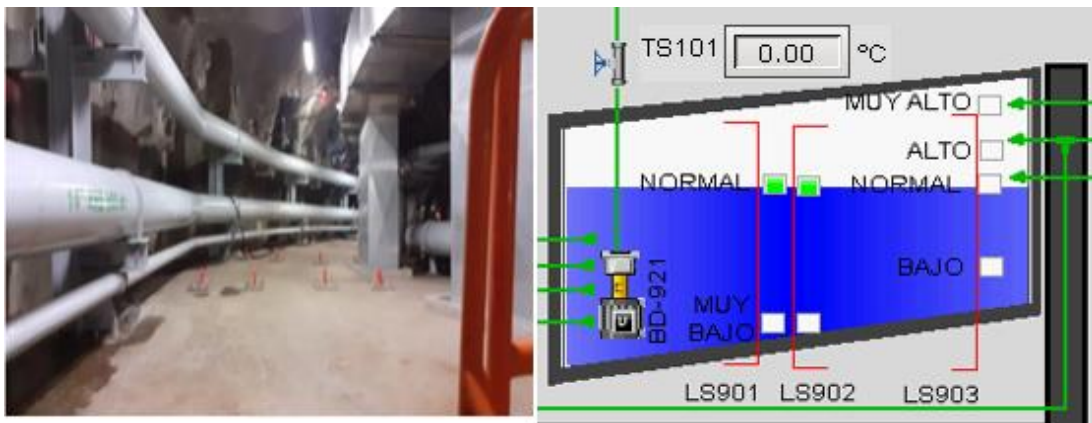
Figura 227. Tanque de Bombeo del NSAE
