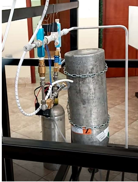
Fig. 10 Vista general del Sistema de distribución de fluido criogénico
