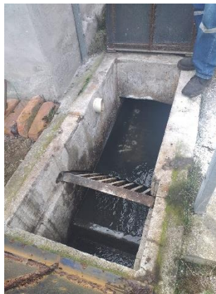
Figura 41. Rejillas y Control
