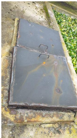
Figura 49. Compuertas de protección
