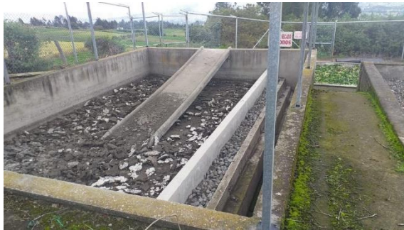
Figura 45. Lecho de secado de lodos
