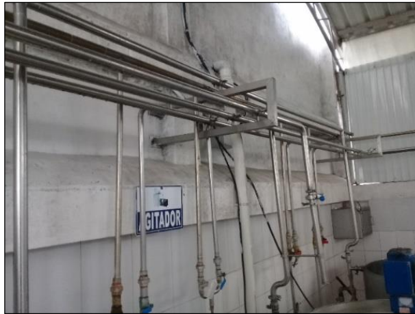
Figura 18: Tuberías de flujo de vapor y de agua
