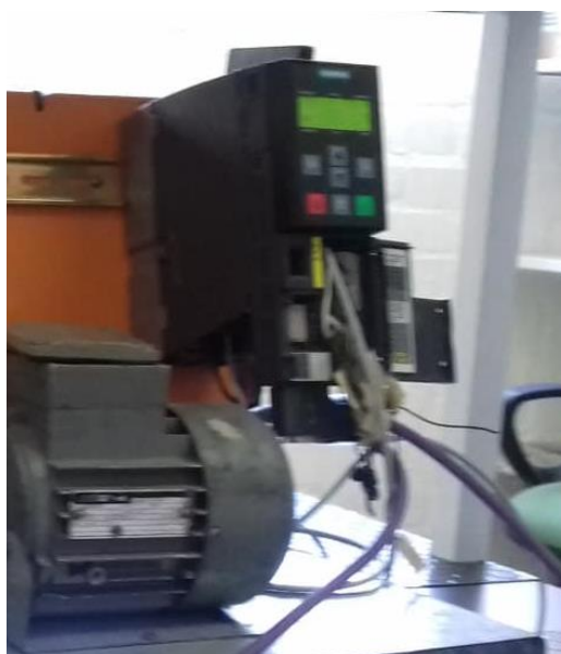
Fig. 4. 4. Variador de frecuencia.
