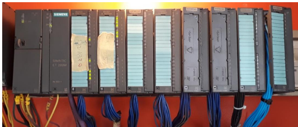
Fig. 4. 3. ET 200 M con 8 módulos de E/S ubicado en un bastidor.
