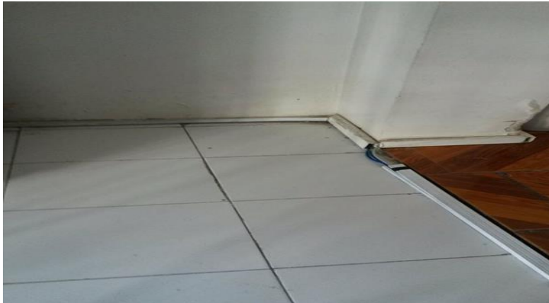
Figura 58. Canaletas puesto en el departamento de cajas
