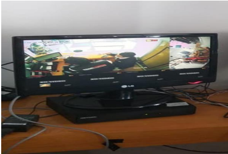
Figura 64. Cámara de seguridad en el área de sistemas
