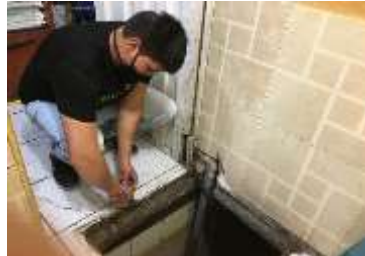
Figura 133 Instalación de Sensor Ultrasónico
