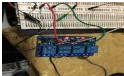
Figura 148 Etapa de Potencia
