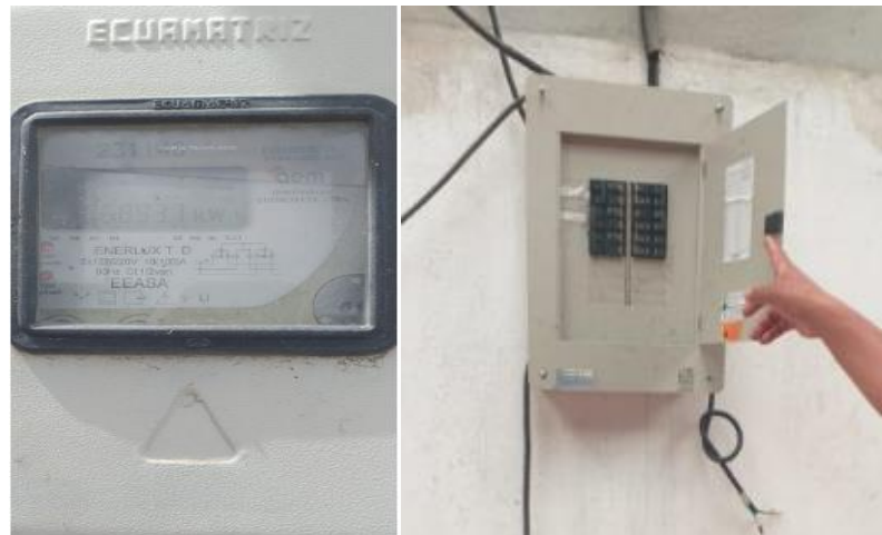
Figura 33. Medidor Eléctrico y caja de distribución de la planta APROLEQ
