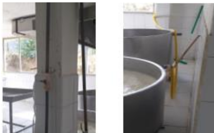
Figura 37. Ingreso y salida del sistema de calentamiento para la marmita
