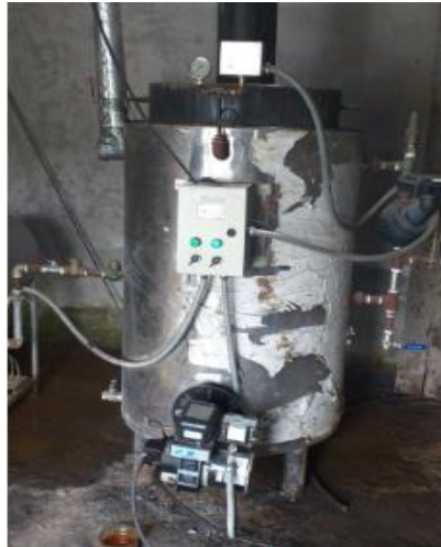
Figura 34. Caldero acuatubular de 2pasos de 10BHP de la planta APROLEQ Elaborado por: El investigador
