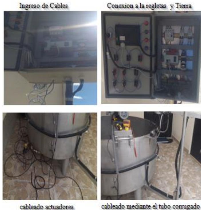
Figura 115. Cableado de los actuadores hacia el armario
