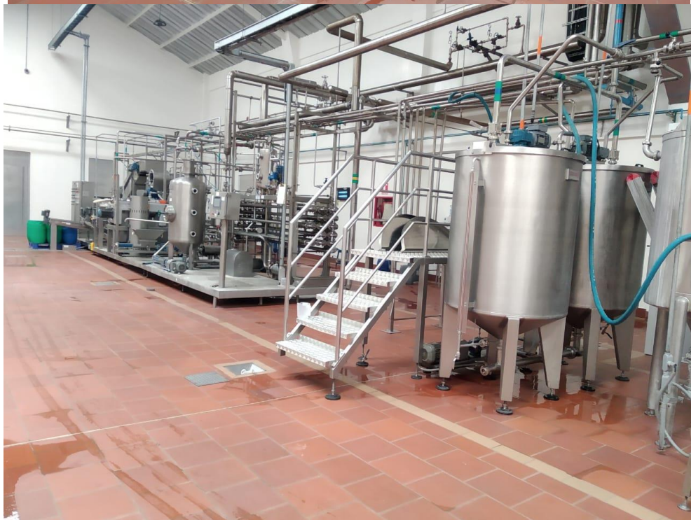
Arriba: Línea de producción manual para procesos de lavado, corte y adecuación previa de la materia prima o productos semiprosesados. Abajo: Línea de producción automática, para procesamiento de pulpas de fruta.
