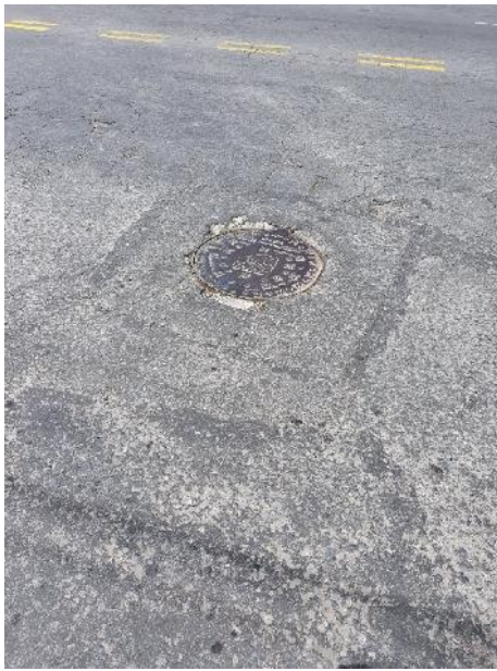
Identificación del tipo de fallas
