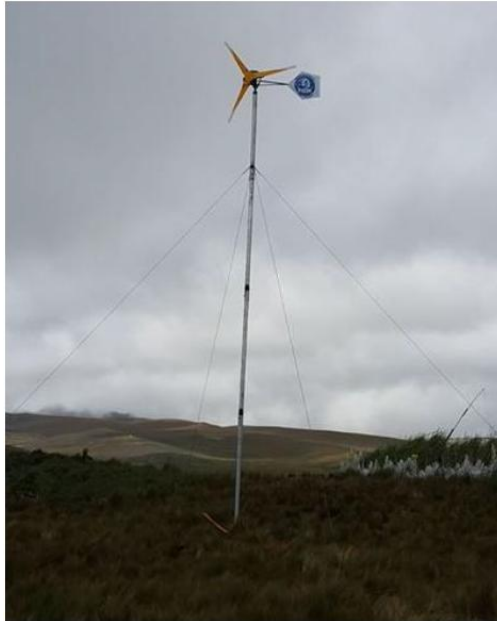
Figura 12. Aerogenerador de Yatzaputzán
