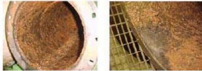
Figura 3. Tuberías oxidadas en el interior
