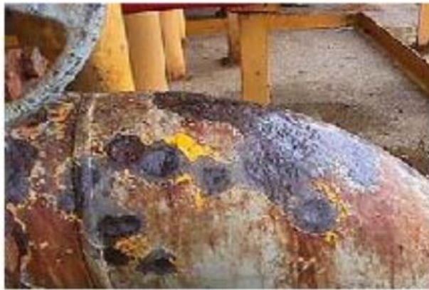
Figura 2. Corrosión por picaduras. [15]
