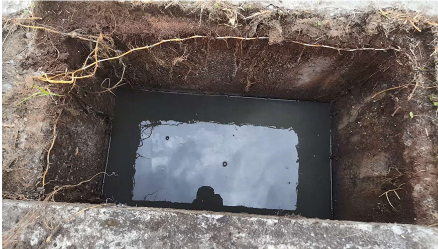
Figura 19 Filtro de flujo ascendente PTAR
