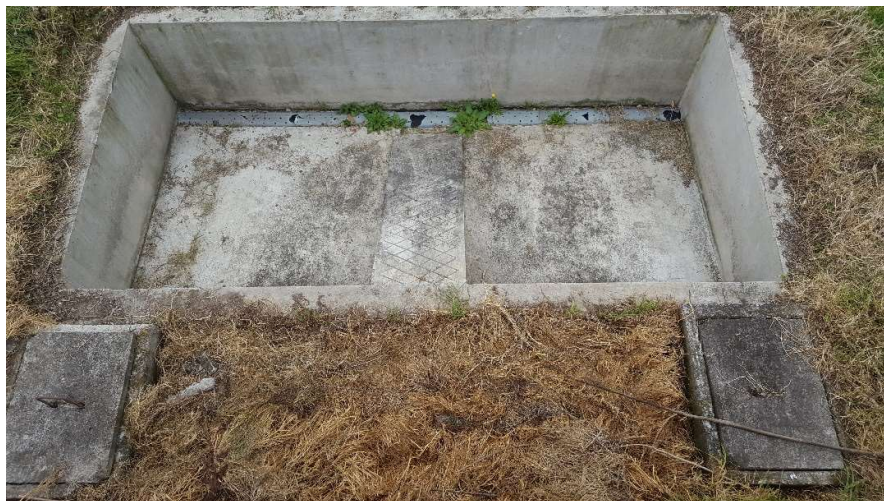
Figura 20 Lecho de secado de lodos PTAR
