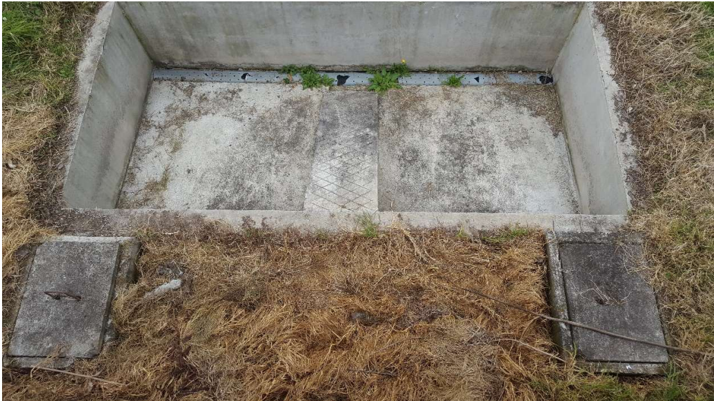
Figura 40 Lecho de secado de lodos
