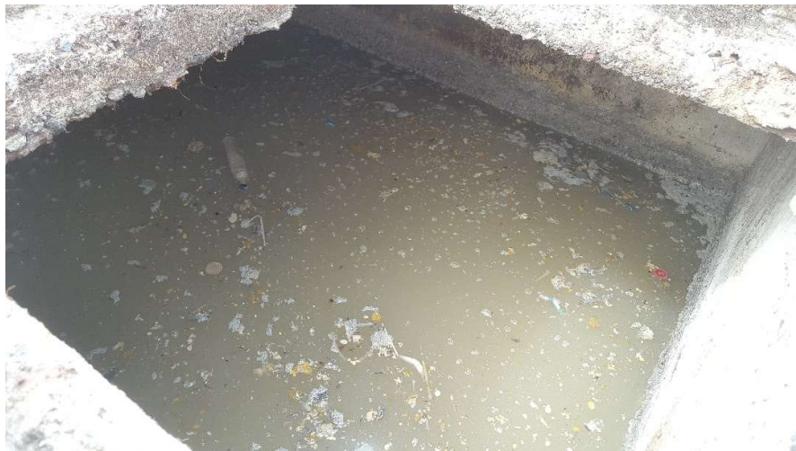
Figura 18 Tanque séptico PTAR
