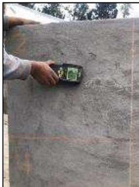
Figura 29: Medición de humedad del muro. Fuente: Alejandro Campaña
