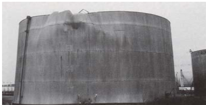
Figura 2.12 Falla de un tanque por pandeo
