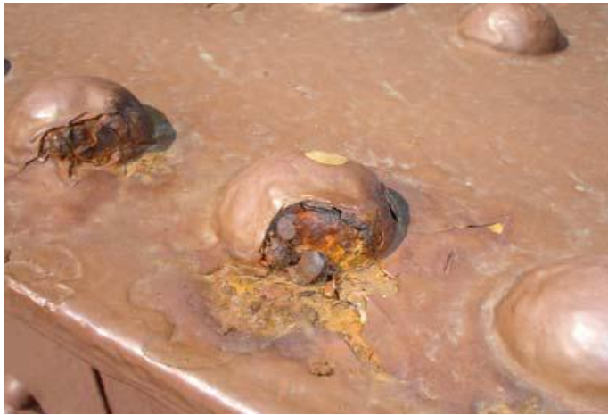
Figura 2.13 Falla por corrosión
