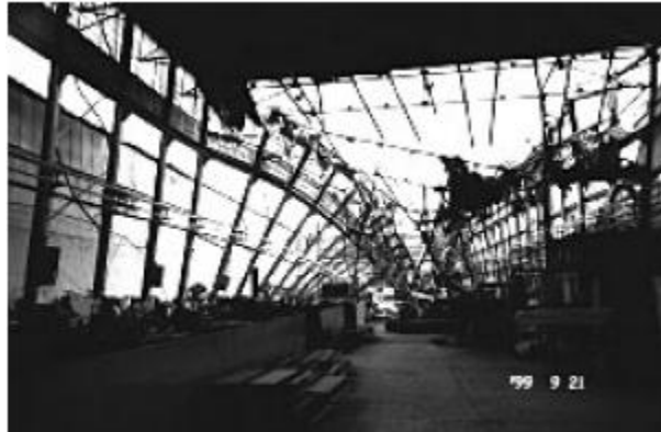
Figura 2.9 Fallas en celosías
