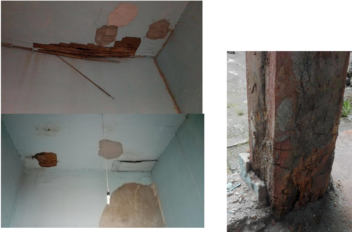
Imagen 63: Patologías / Techos / Columna
