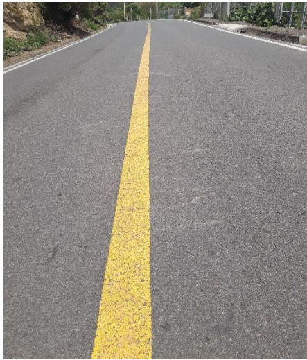
Ubicación de la sección y reconocimiento de las fallas existentes sobre la capa de rodadura.
