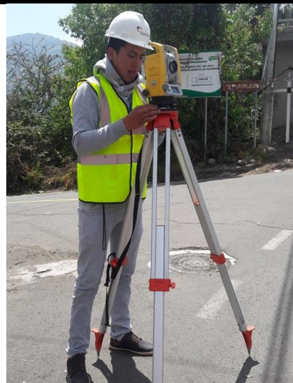
Configuración de estación total e ingreso de coordenadas en el punto inicial del proyecto.
