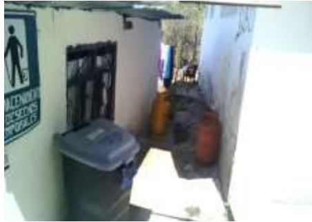
Imagen 34: Tanques de gas sin debido almacenamiento y expuesto al contacto con pacientes
