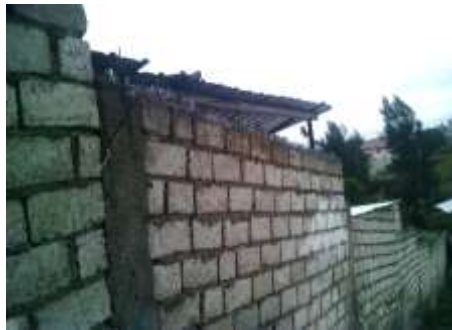
Imagen 31: Vidrio roto en borde superior de cerramiento
