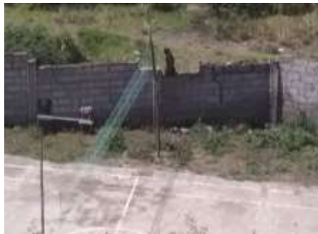
Imagen 32: Cerramiento posterior en estado de deterioro
