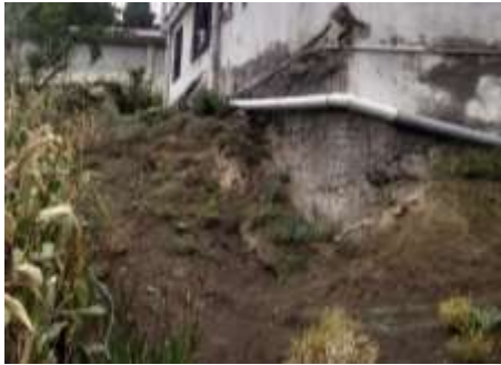
Imagen 28: Fachada lateral izquierda, terreno deteriorado
