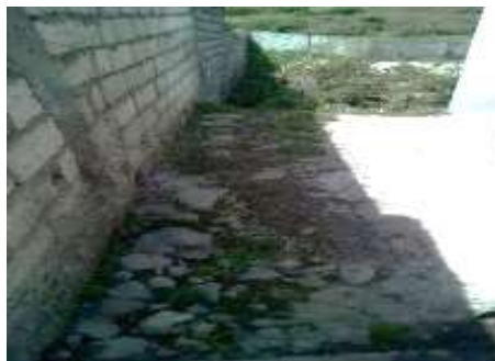
Imagen 33: Áreas de circulación externa deteriorada
