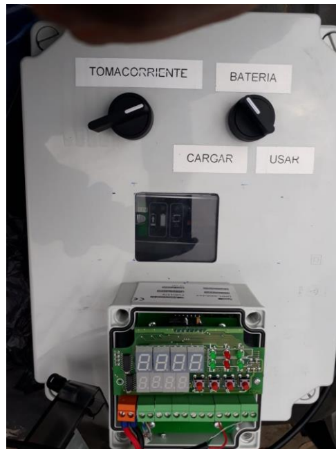
Equipo completo para medición de caudales con su respectiva batería para su uso en campo
