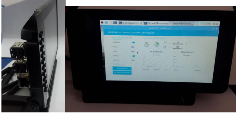
Fig. 6.70. Touch screen Raspberry en área de operaciones peaje Intevalles
