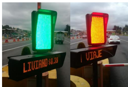
Fig. 6.75. Control de semaforización
