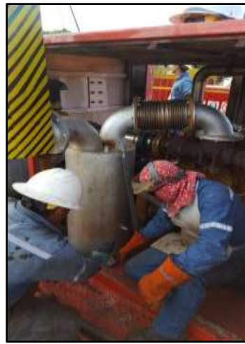
Imagen 2: Condición subestándar Partes calientes sin protección
