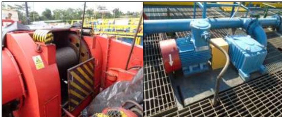
Imagen 31: Guardas de seguridad en partes de equipos en rotación
