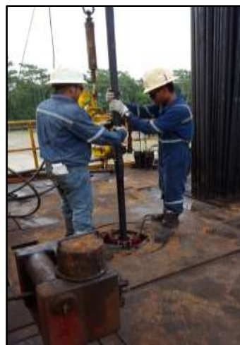
Imagen 4: Condición subestándar Piso de trabajo no es antideslizante
