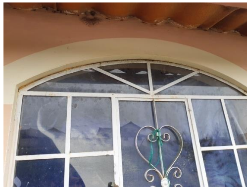
Fotografía 28. Ventanas Perdida de calor Autor: Aldás J. (2018)
