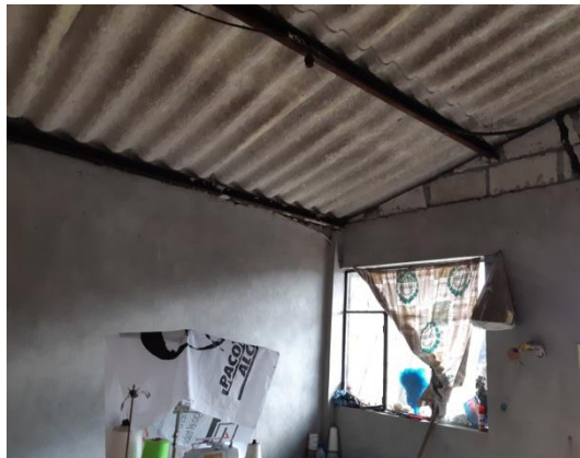
Fotografía 26. Filtración de aire – Unión entre pared y cubierta. Autor: Aldás J. (2018)
