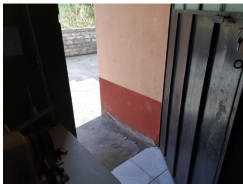
Fotografía 36. Humedad / Puerta metálica Autor: Aldás J. (2018)
