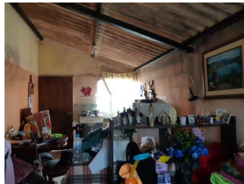
Fotografía 29 Condensación - Humedad Autor: Aldás J. (2018)
