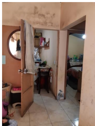
Fotografía 30. Condensación - Humedad Autor: Aldás J. (2018)
