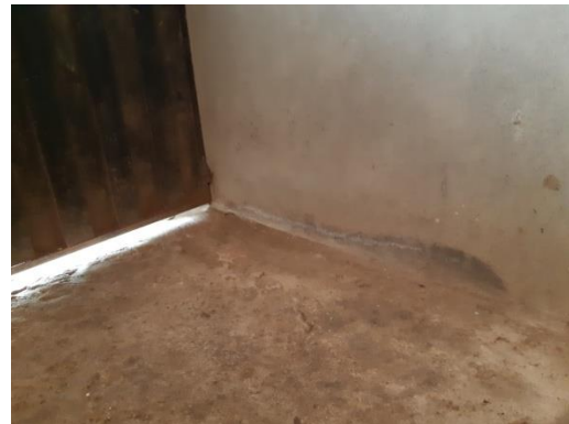
Fotografía 33. Pérdida de calor / puerta metálica Autor: Aldás J. (2018)
