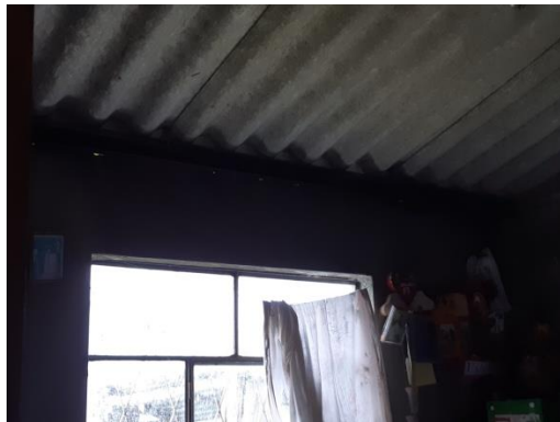
Fotografía 32. Filtración de aire, pérdida de calor Autor: Aldás J. (2018)
