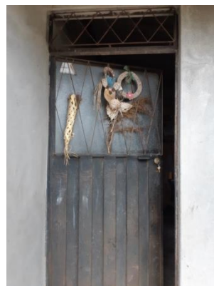
Fotografía 37. Pérdida de calor por la tarjeta superior de la puerta / Materia metálica Autor: Aldás J. (2018)
