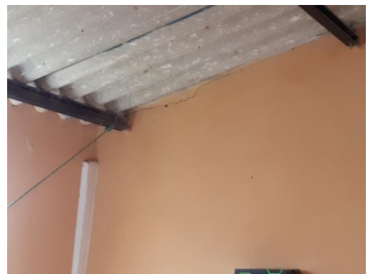
Fotografía 35. Fisuras en la pared Autor: Aldás J. (2018)
