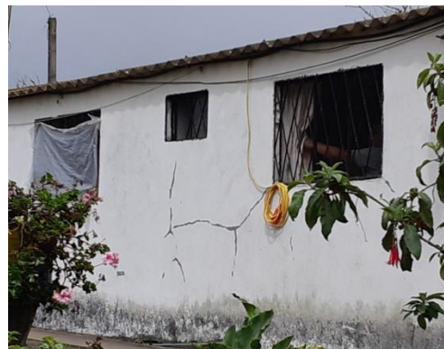
Fotografía 31. Fisuras en paredes Autor: Aldás J. (2018)
