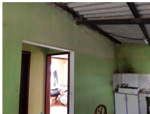
Fotografía 34. Humedad y filtración Autor: Aldás J. (2018)
