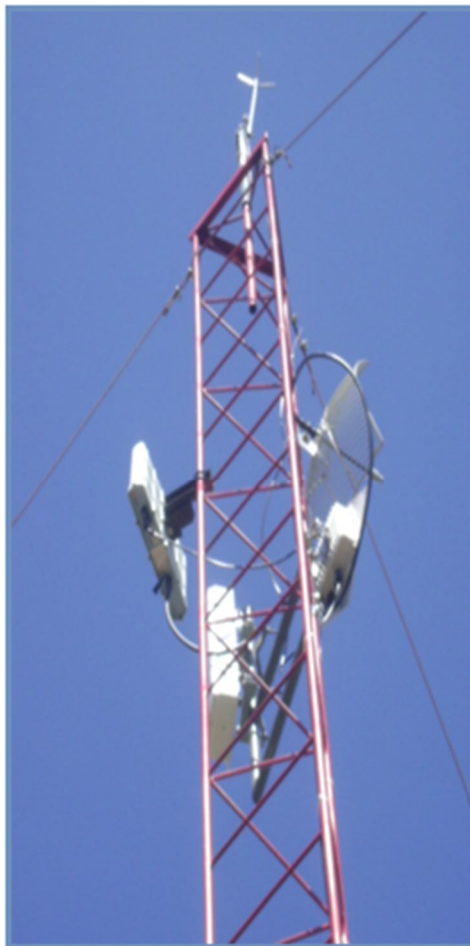
Figura. 4.5 Infraestructura de telecomunicaciones – Nodos
