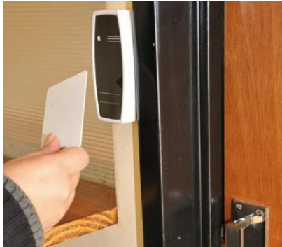
Fig. 6.5 Lector de tarjetas de proximidad
