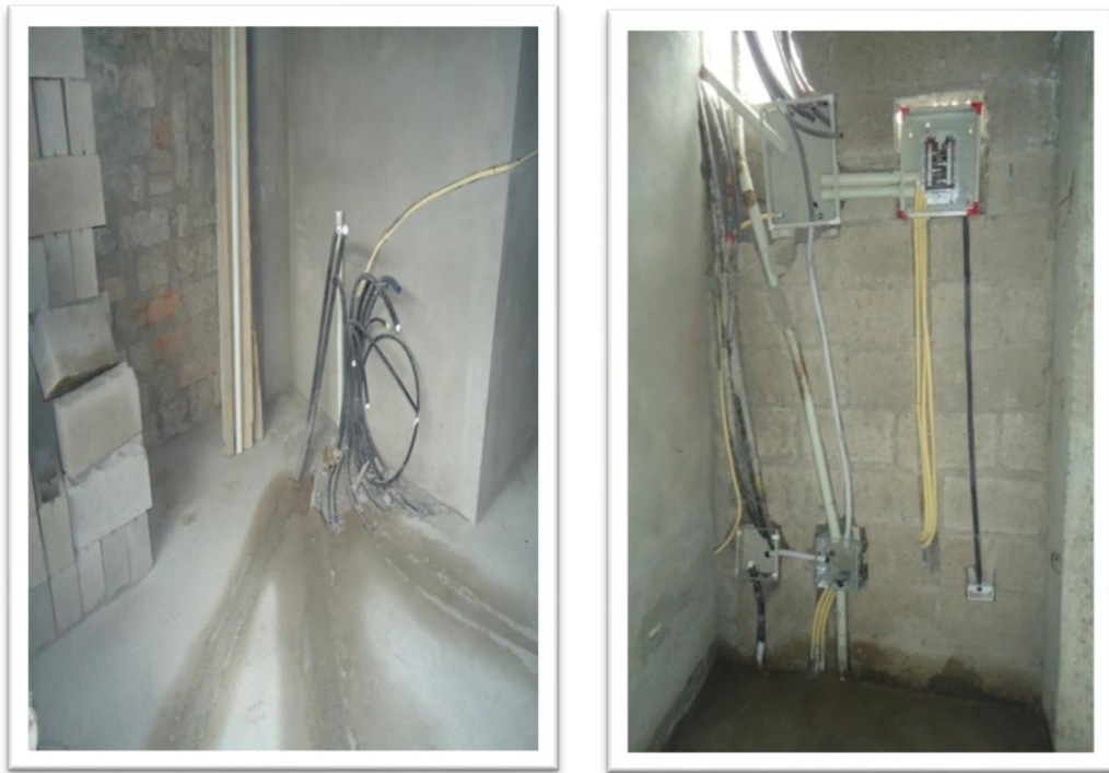
Fig. 4.2 Conductos para el cableado
