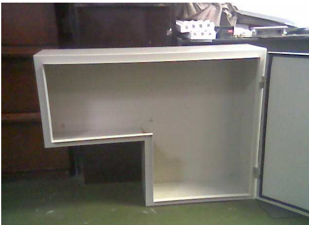
Distribución de canaletas y rieles.
