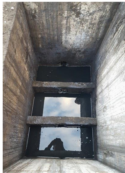
Pozo de trampa de grasas
