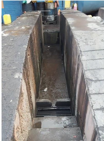
Imagen 4. Pozos recolectores del afluente
