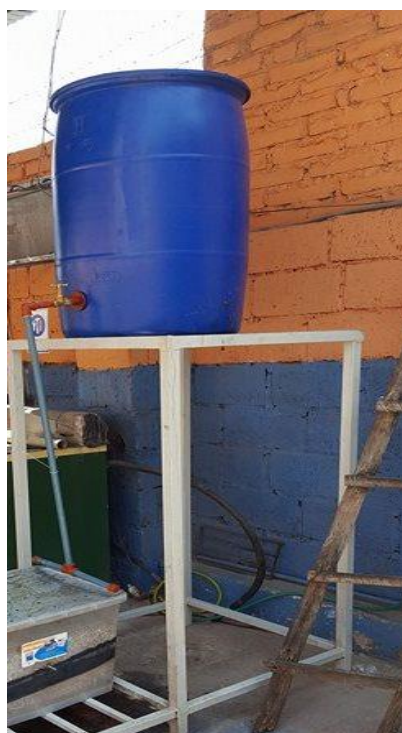
Imagen 7. Estructura metálica y tanque plástico de 55 gal
