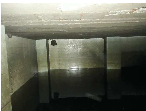
Tanque subterráneo de reserva de agua
