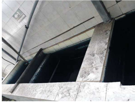
Imagen 6. Tanques de sedimentación.
