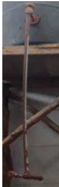
Imagen 8. Tubería por donde fluye el agua residual
