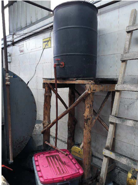
Imagen 10. Filtro en funcionamiento
