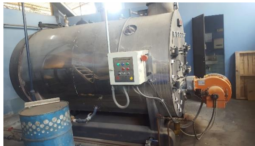
Figura 3-3: Caldera de vapor pirotubular.
