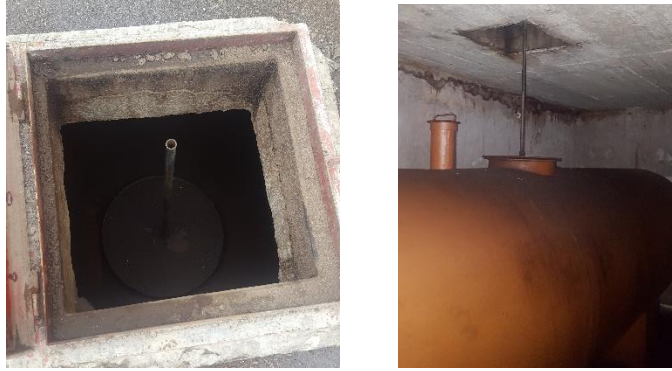
Figura 3-5: Depósitos de diésel filtrado N°3.
