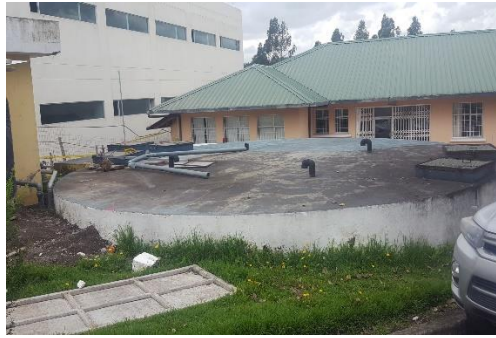
Figura 3-9: Almacenamiento y suministro de agua a la caldera.
