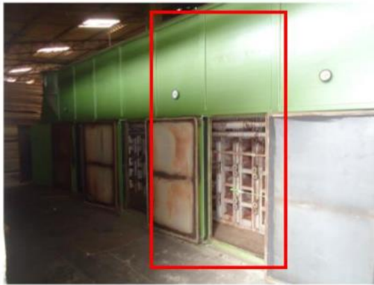
Figura 4-2. Cámara No. 4 secador continuo
